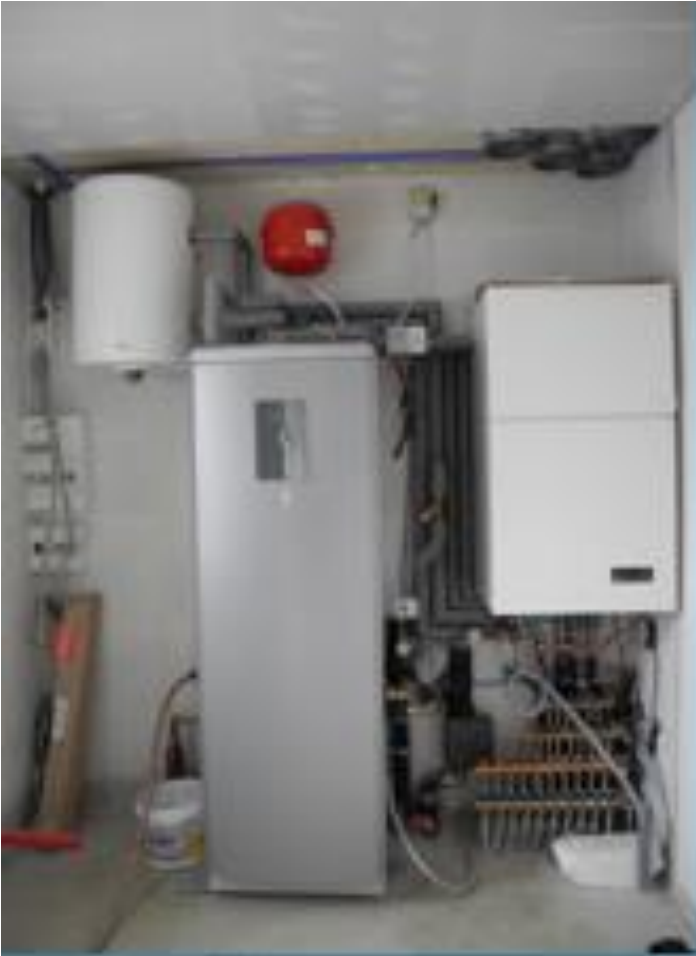
Figur 9. Varmepumpeinstallation i Silkeborg.
